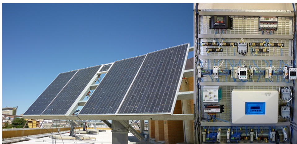
Figura 1: Sistemas Fotovoltaicos Autónomos. Armario de Conexiones Eléctricas.
